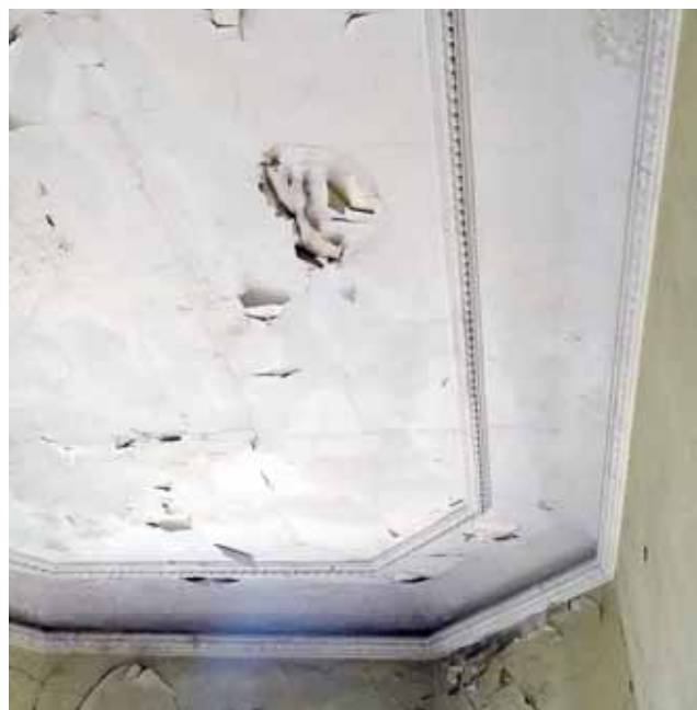
Ilustracja 1-18. Fragment wystroju sztukatorskiego na suficie głównej klatki schodowej w kamienicy przy Alejach Jerozolimskich 57, stan z 2017 roku. Fot. P. Kilanowski
